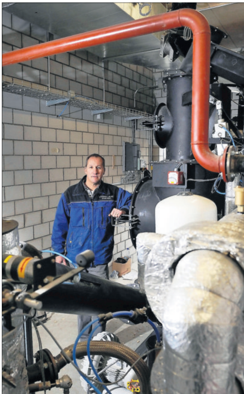
Urs Steinger, Betriebsleiter des Sägewerks Riedbrugg in Ettiswil, vor der Holzvergaseranlage. Bild Boris Bürgisser
